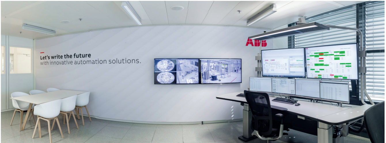
Im Steuerungsraum werden Informationen für die Steuerung der Produktion zusammen mit Live-Stream-Bildern im HMI dargestellt. Dies ermöglicht es einer Person, die gesamte Produktion zu steuern.
